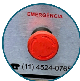
Botão de emergência
